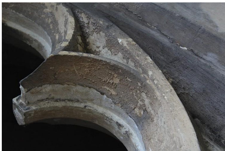
Obrázek 1: Hrobka Chotků, okno v jižní stěně, detail kružby se zachovalým povrchem a pravděpodobným výskytem nátěrů, fotografii poskytl zadavatel průzkumu
